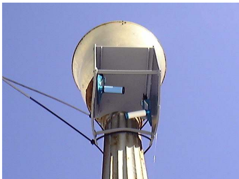
Figura 2 – Imagem da colocação típica do sistema de amostragem nos postes de iluminação a cerca de 4 metros de altura.
